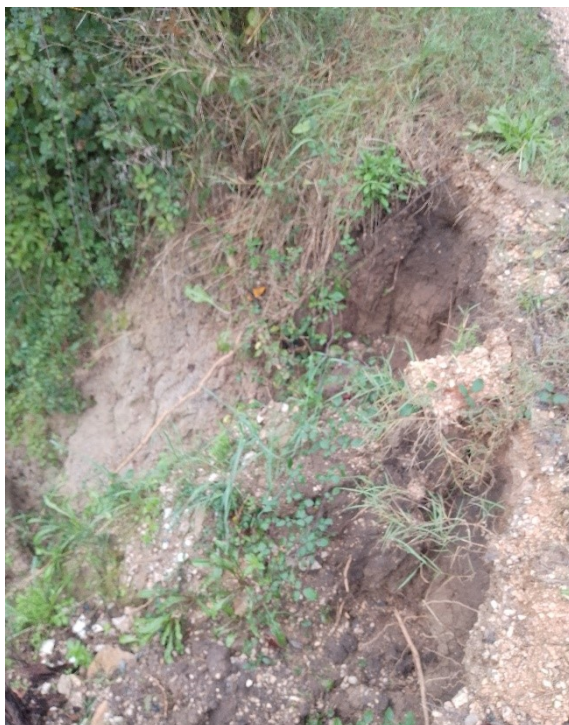
Imatge 6. Detall talús i esllavissada a ras de la Via
