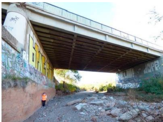
Soscavació marge dret, pila 1, vista des de aigües avall
