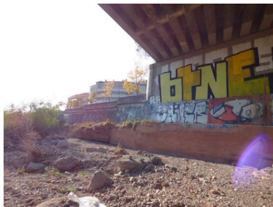
Soscavació marge dret, pila 1, vista cap a aigües avall
