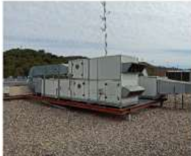
Figura 37. Climatitzador del Bloc C
