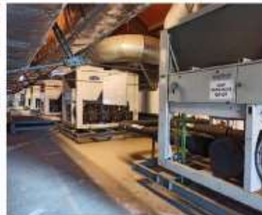
Figura 52. Equips de producció de climatització.
